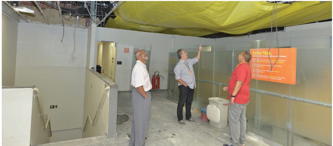
Os diretores do Sindicato Carlos Antonio Vovô, Reinaldo Silveira e Celso Fumaux mostram a situação precária da agência do Itaú, em obras, no bairro de Madureira
