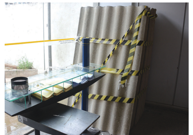
Os diretor Samuel Braun e a diretora Luciana Vieira apontam avarias na parede da agência. Acima, escada obstruída
