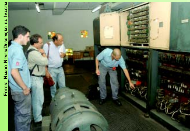
O diretor do Sindicato Paulo Matileti (segundo da esquerda para a direita), junto com o fiscal e os técnicos de manutenção, observa o desempenho das máquinas dos elevadores
