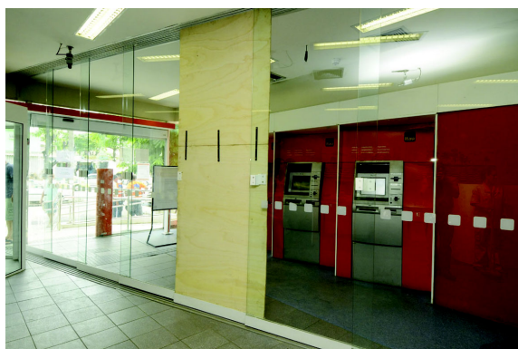
Tapume colocado para substituir vidraça estilhaçada na agência Jardim América após ação de bandidos, em abril. A unidade do Itaú já sofreu 12 assaltos
