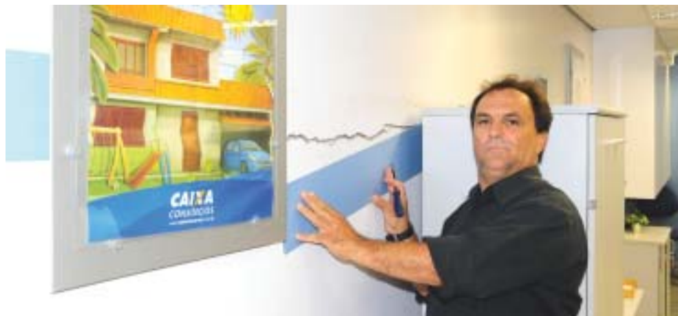
DISFARCE - A Caixa colocou papel de parede para esconder parte das rachaduras
